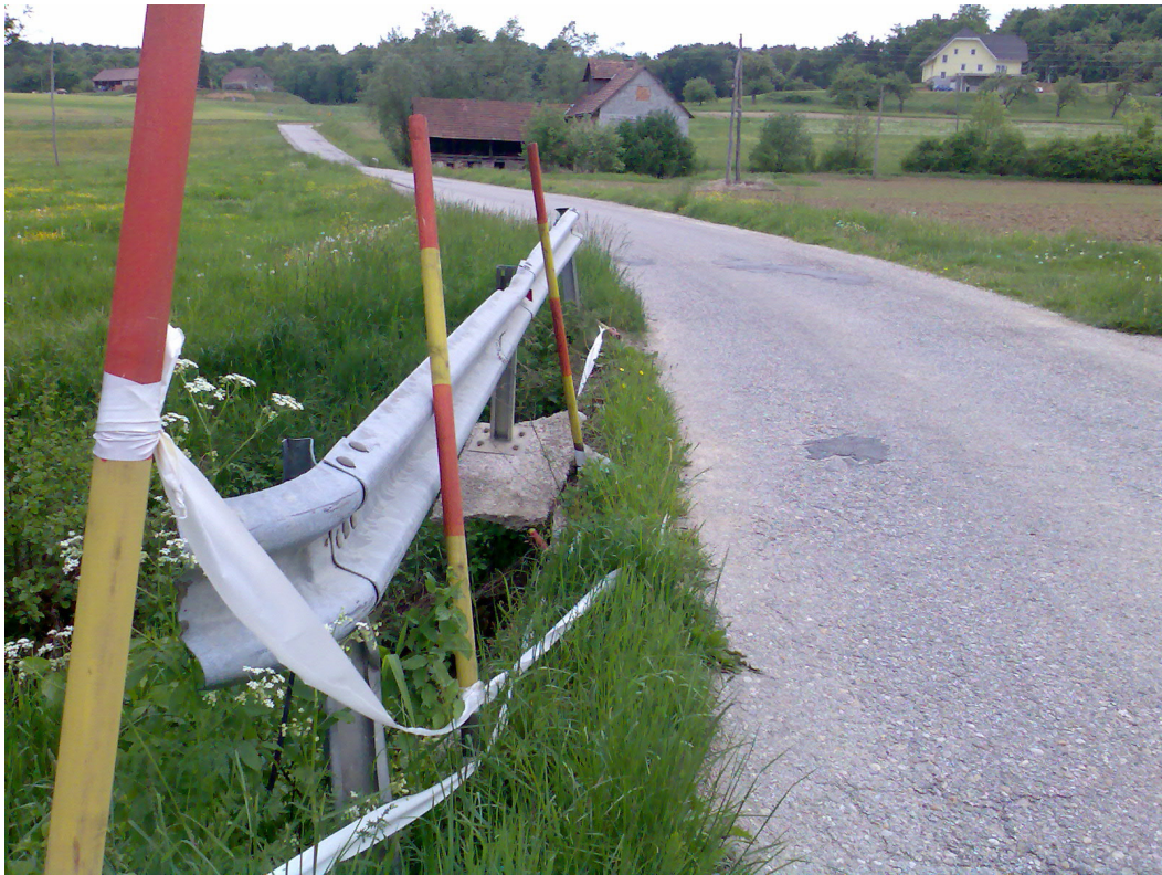
Neustrezna signalizacija poškodbe na cesti
